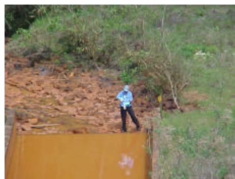
Vertedouro da Barragem Santarém – Águas turvas
