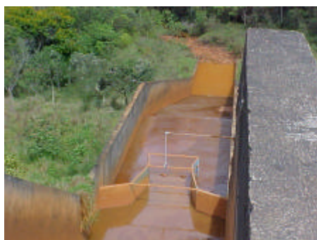
Vertedouro da Barragem Santarém – Águas turvas
