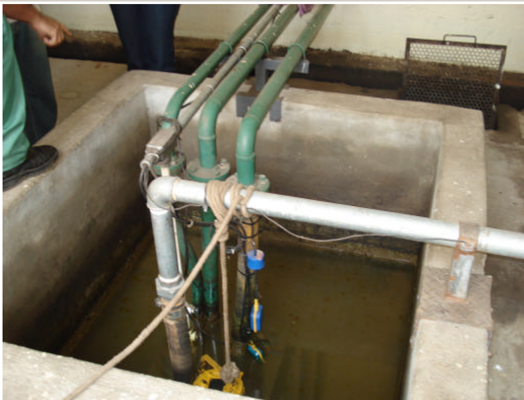
Foto 2 – Detalhes da caixa receptora da água contaminada com óleo proveniente das turbinas.
