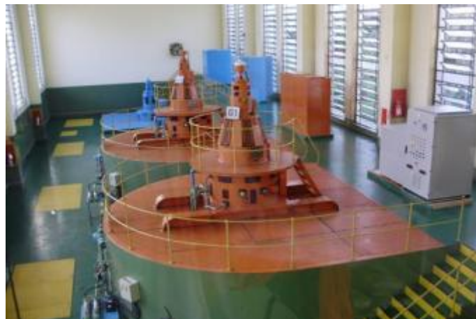
Foto 6 - Turbinas da Casa de Força.
