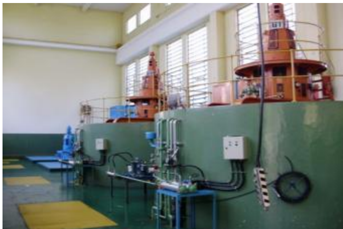
Foto 5 - Turbinas da Casa de Força.
